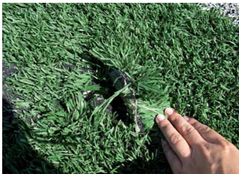
Figura 19. Rotura de una junta del césped artificial
